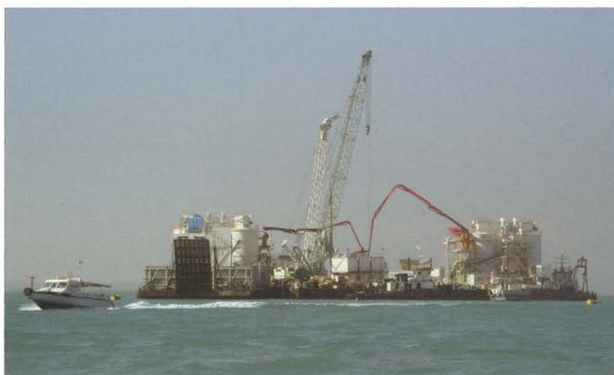
Figura 9: I due pontoni attrezzati per il getto del calcestruzzo e un dettaglio della fase di getto. Nella foto sono chiaramente visibili i bracci articolati, di colore rosso, che trasportano il calcestruzzo a bocca palo. I due bracci articolati sono posizionati in corrispondenza dell'imbuto del tubo getto che trasporta poi il calcestruzzo a fondo palo
