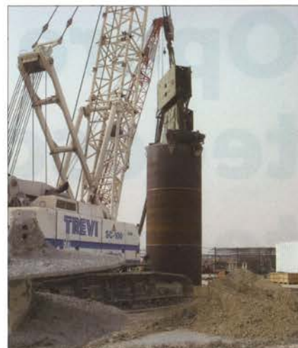
Figura 11: Alcune fasi della lavorazione: posa dei tubi in acciaio, scavo di un palo e particolare dell'attrezzatura di scavo per la realizzazione di pali sulla battigia
