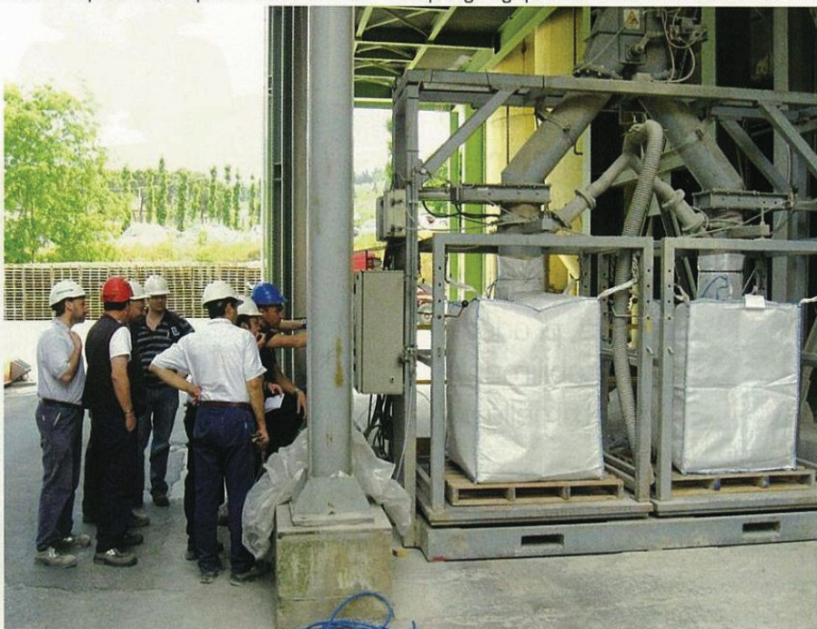
Messa a punto dell'impianto automatizzato "riempi big bag" presso lo stabilimento di Settimello
